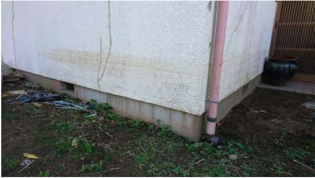
写真上：浸水により住宅の外壁についた汚れ(膝上の高さまである)
