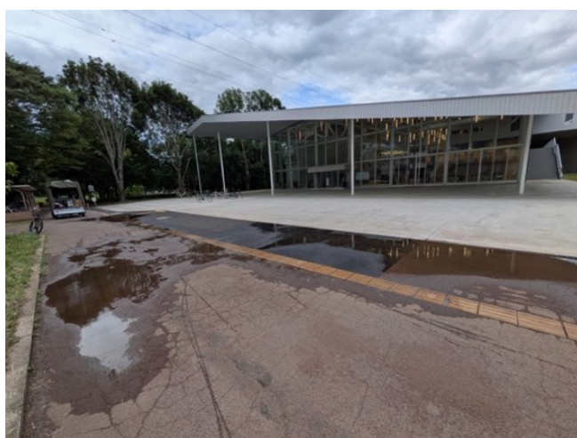
写真 4 舗装された道でも水たまりはできていました (6月4日撮影)
