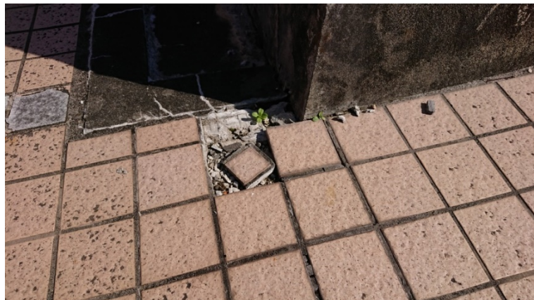
割れてしまったペデのタイル（第一エリア）
